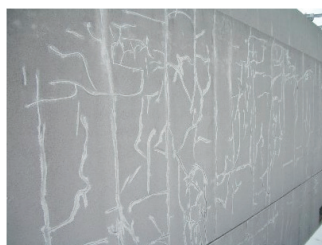
▲ひび割れの補修跡
