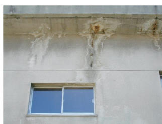
▲鉄筋の錆び汁と白華
