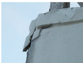
▲劣化による剥落
