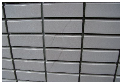
▲タイルの割れ
