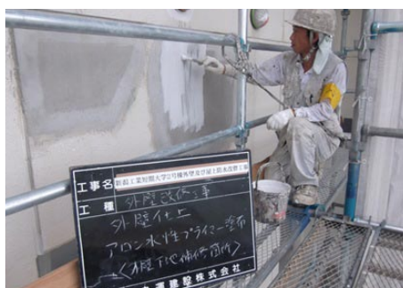
2) アロンウォール NEO 工法 アロン水性プライマー塗布 (下地補修部分)
