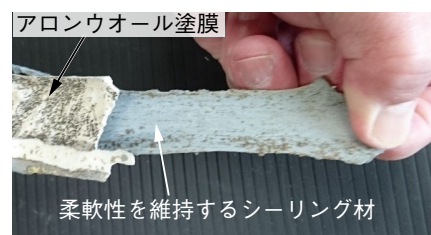
写真4 アロンウオールのシーリング材保護効果（施工後25年）
