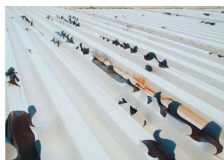
従来の防錆塗料の劣化
